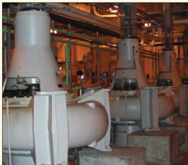
Avloppsvattenpumparna ovan använder delade tätningar med 200 mm diameter och har varit i drift i mer än 12 år.
